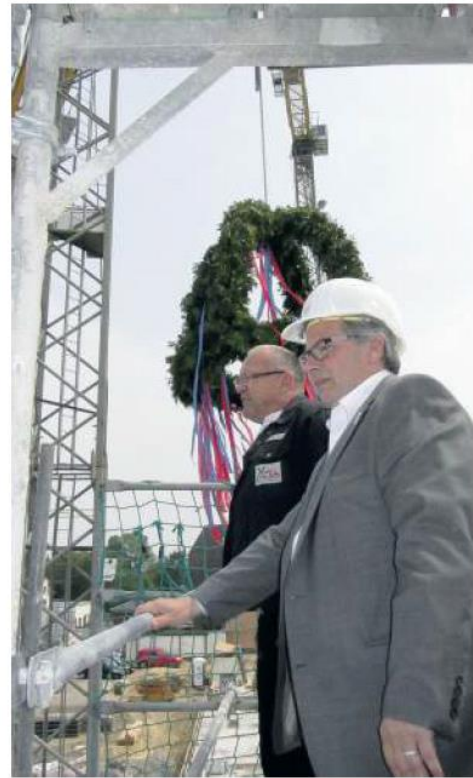
Oben am Giebel des Stadthauses Im Lindenhof 10 sprach Zimmermeister Willi Alms mit GWG-Vorstand Andreas Otto den Richtspruch. Foto: Franz
